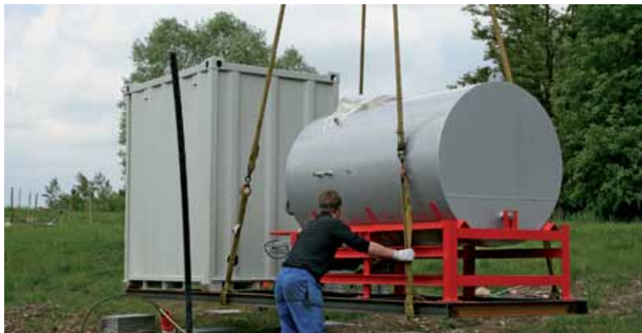
Die vormontierte Schwachgasabfackelungsanlage mit 200 kW bzw. 100 m 3 /h Leistung wird auf der Deponie platziert.
